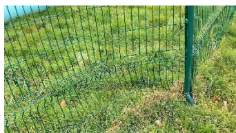
clôture endommagée réserve incendie aux Cabots
